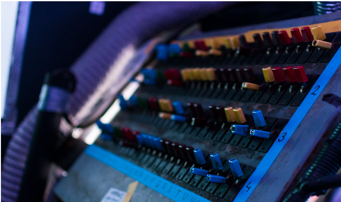
Kierrätimme löydettyjen laitteiden osia aluksen järjestelmien ja lavastuksen osaksi. ( Odysseus Engine room spectral recalibration switchboard . Valokuva: Mira Strengell.)
