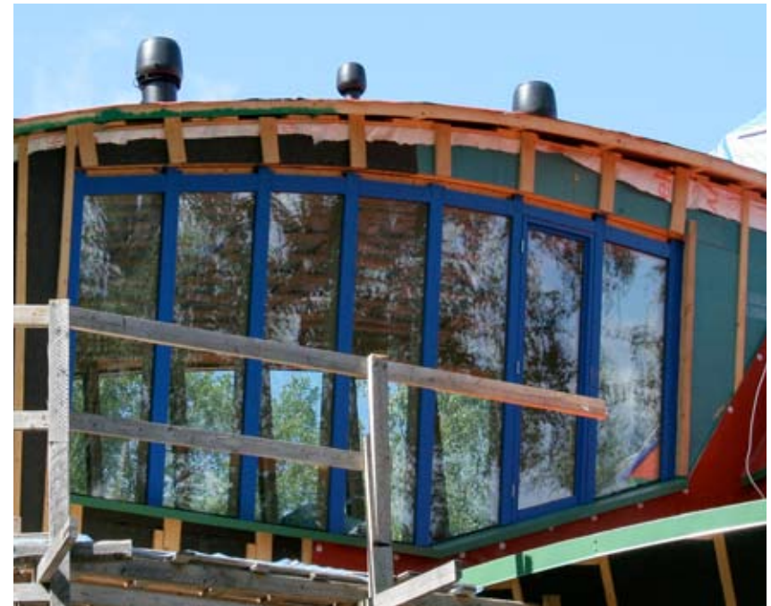
Datorstudion (i halvfärdigt skick) med ventilationspipor. Fönsterprofilernas färg och struktur är ämnade att påminna om färjan i Brasilien på bilden intill. Bilden tagen 30.7.2008.
