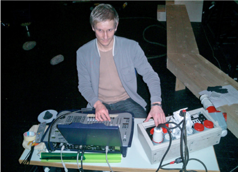
Kuva 23: Valonohjauksen työvälineet koostuivat himmentimien ja valopöydän lisäksi kuvassa näkyvästä voimavirtakeskuksesta, jonka automaattisulakkeista sytytin ja sammutin käyttämiäni katuvalaisimia.
